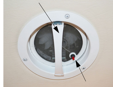
Fan Power Switch
